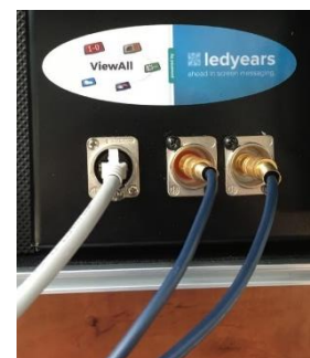
Kabels aangesloten voor netwerk (links) en geluid (2x rechts)
